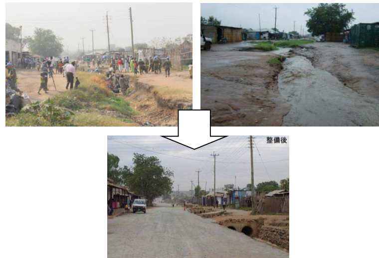
路面浸食の状況(上左)と、降雨時の冠水状況(上右)。整備後(下)。
