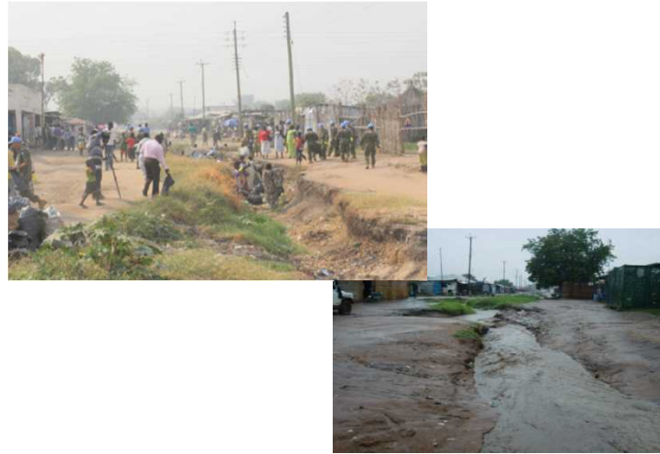
路面浸食の状況(左)と、降雨時の冠水状況(右)。
