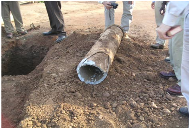
破損した既存給水管
