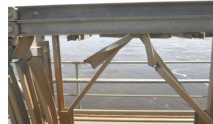
既存橋老朽化状況
